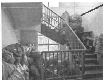
图1 楼梯堆放杂物，堵塞疏散楼梯
