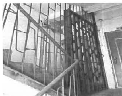
图2 在疏散楼梯上安装铁门，影响疏散
