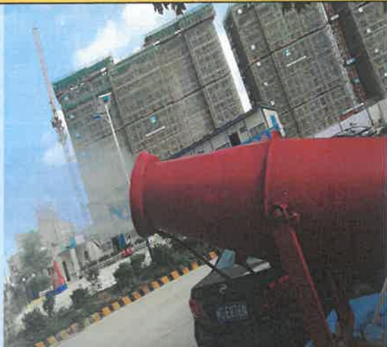
雾炮喷淋实例
