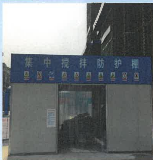
封闭式搅拌防护棚
