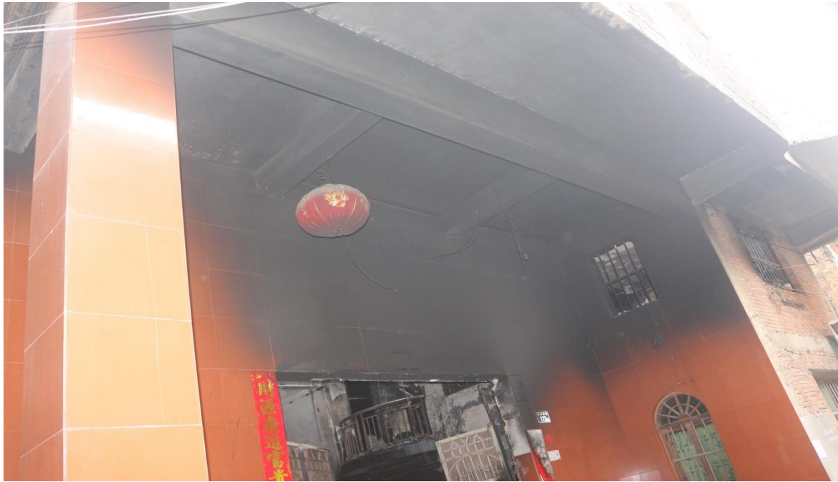
图 1：起火建筑外立面
