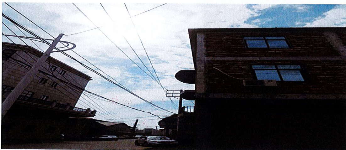
10 千伏三欧线三欧支线#17 杆至伟强支线#1 杆与建筑物现场图片
